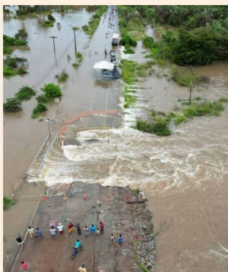
Figura 14 – Estradas completamente bloqueadas devido ao rompimento das pistas
